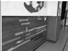
ガムテープで補強された集会室の壁(新城)
